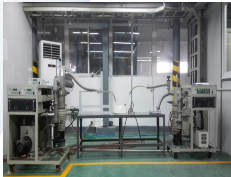
真空ユニット設備
